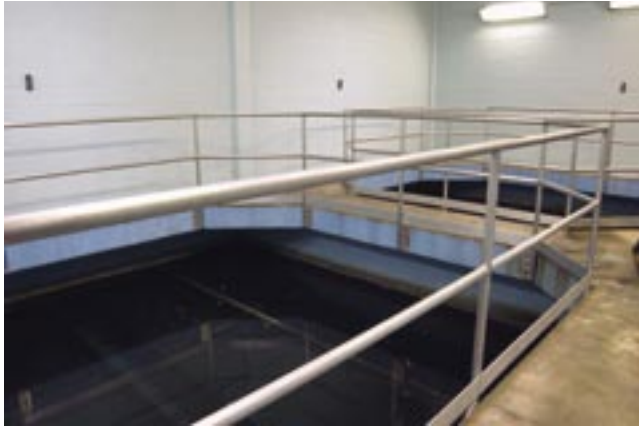
Tanque de filtración del sistema de agua
